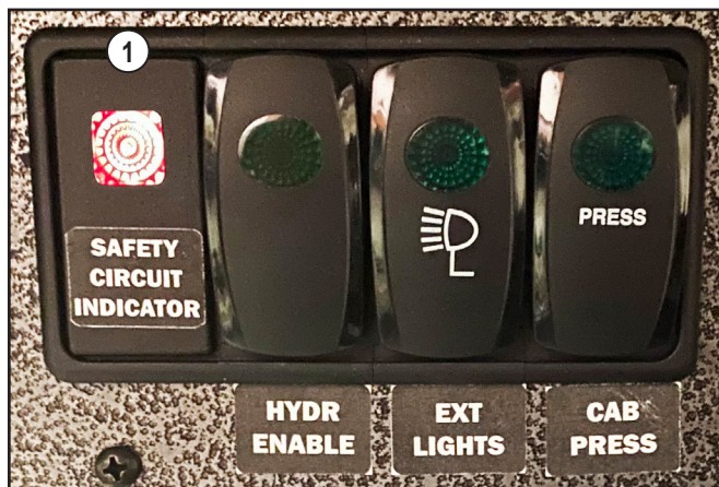
(1) Het lampje van het veiligheids-circuit brandt om aan te geven dat het hydraulische systeem is uitgeschakeld.
